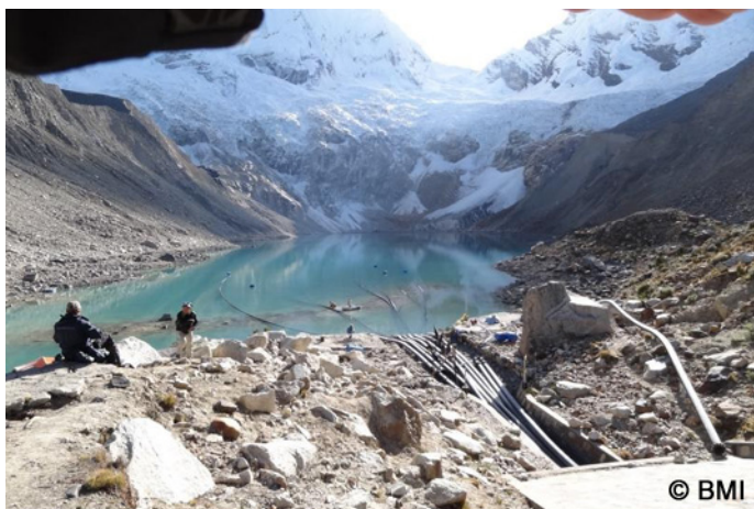
Obras de drenaje en la Laguna Palcacocha, julio de 2013. Photo: D. Hoffmann
