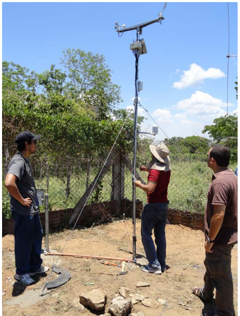
Instalación de una estación de meteorología de última generación para la toma de datos climáticos
